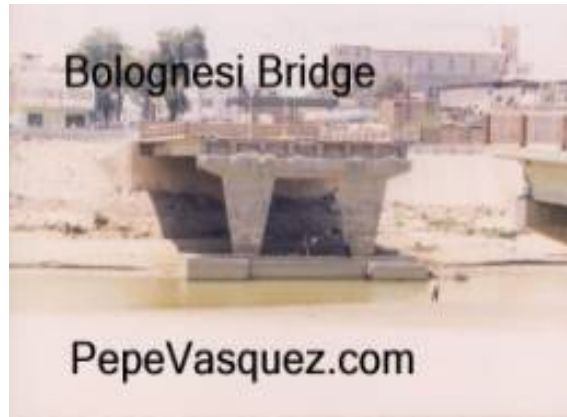
Fotografía 3.3 Erosión General del Puente Bolognesi (Piura-Perú).
