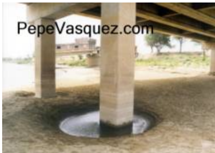
Fotografía 3.1 Foso de erosión local en el Nuevo Puente Independencia en el río Piura.
