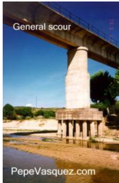
Fotografía 3.2 Erosión General del cauce de un río.
