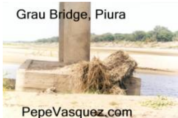
Fotografía 3.4 Erosión General del Puente Grau (Piura-Perú).
