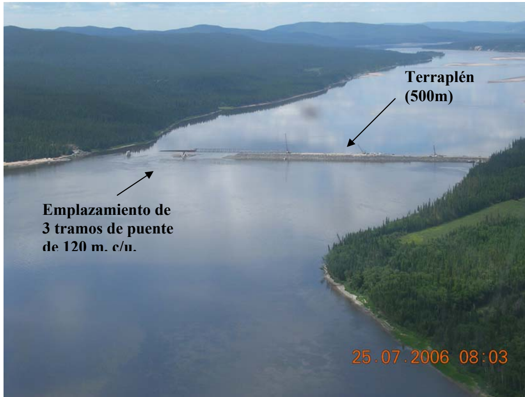
Fotografía 2.2 Puente en el Río Churchill en Canadá durante la colocación del tablero metálico.
